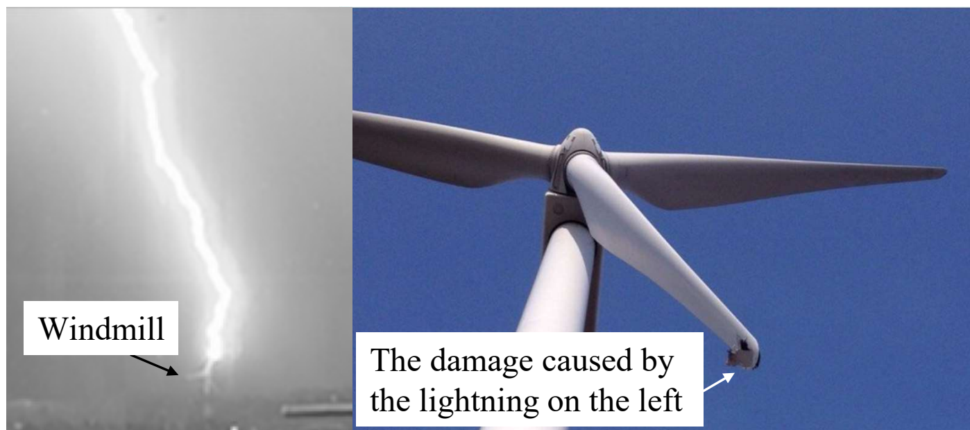
風車ブレードへの落雷様相とその落雷によるブレードでの損傷写真
