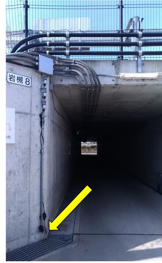
アンダーパスの配管
