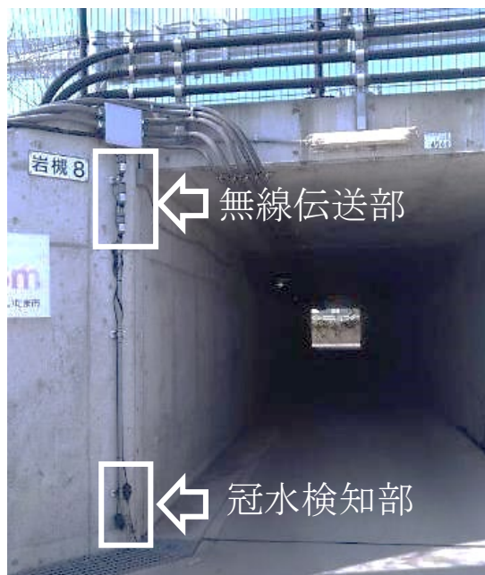
平常時のアンダーパスと 水検知器の設置状況
